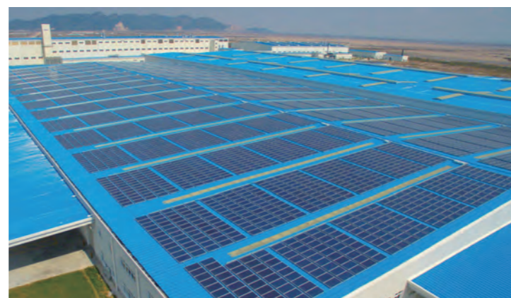
10,3MW ☰ Progetto di copertura fotovoltaica di Geely Automobile 📍 Linhai, provincia di Zhejiang, Cina
