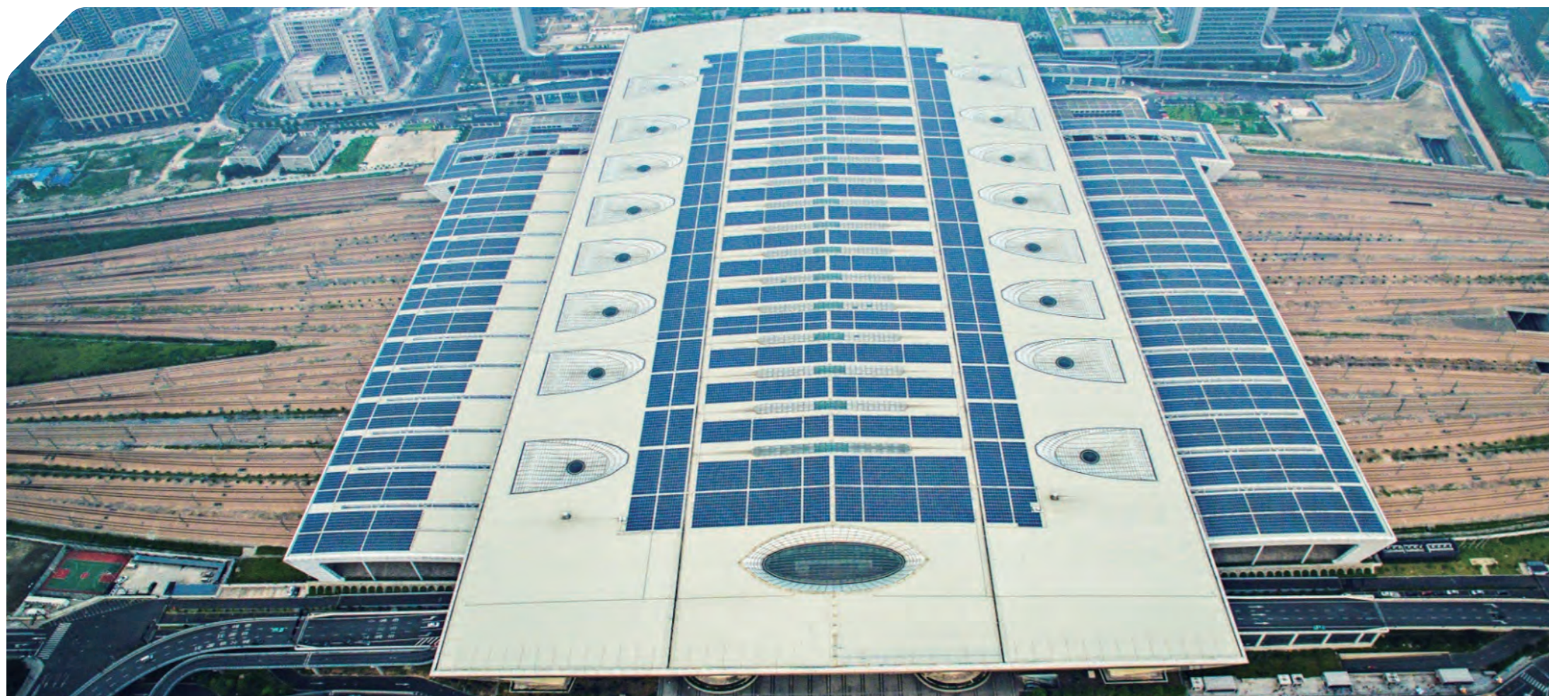
10MW ☰ Centrale fotovoltaica sul tetto della stazione ferroviaria di Hangzhou Est 📍 Hangzhou, provincia di Zhejiang, Cina
